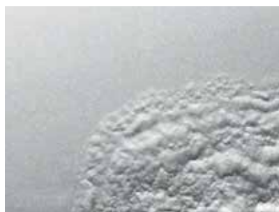
Eau de condensation / corrosion
